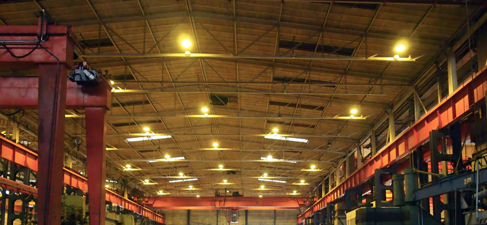
Suurpainenatriumvalaistus teollisuushallin katossa. Kuva: Petri Lähde.
