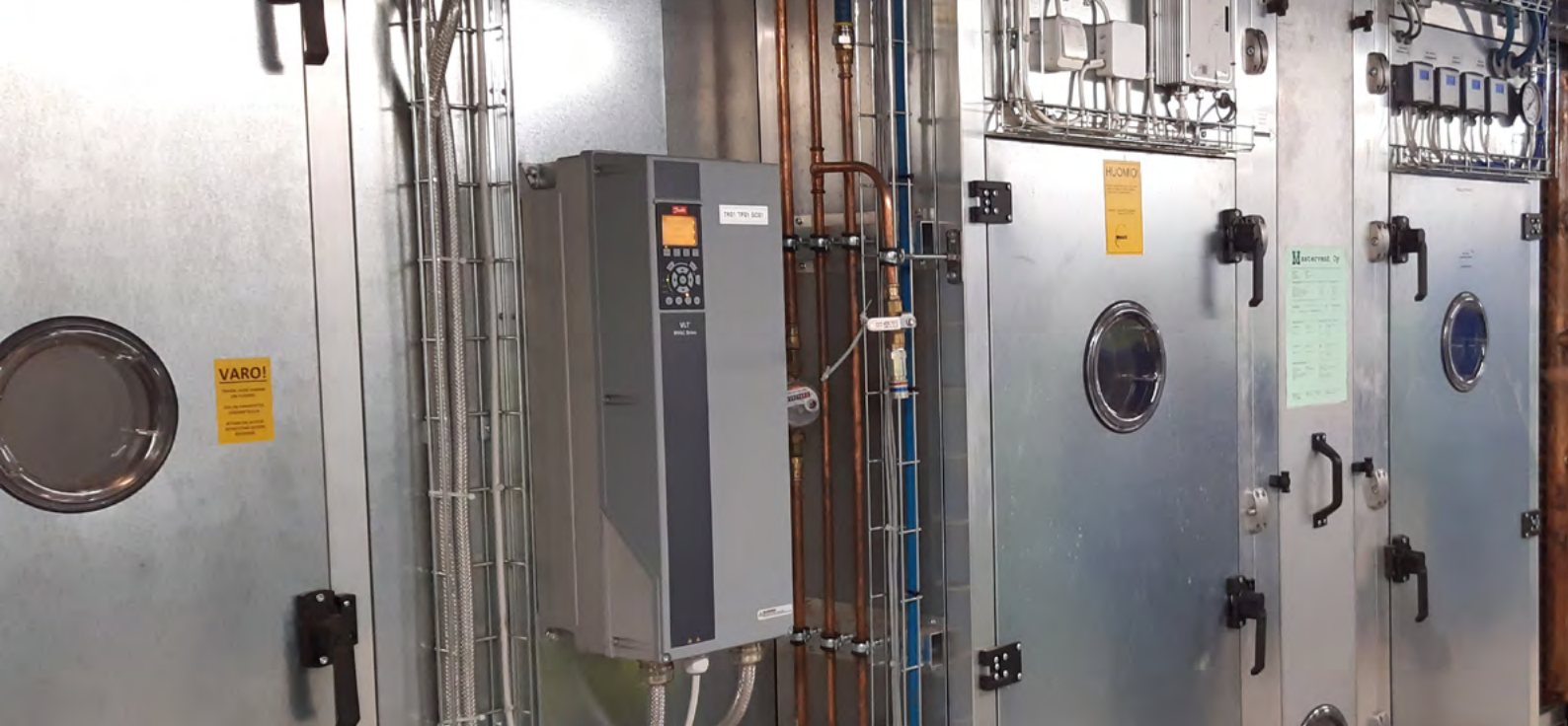
Kuvassa Mastervent Oy:n automaattisella pesujärjestelmällä varustettu IV/LTO-laitteisto. Kuva: Teemu Heikkinen.
