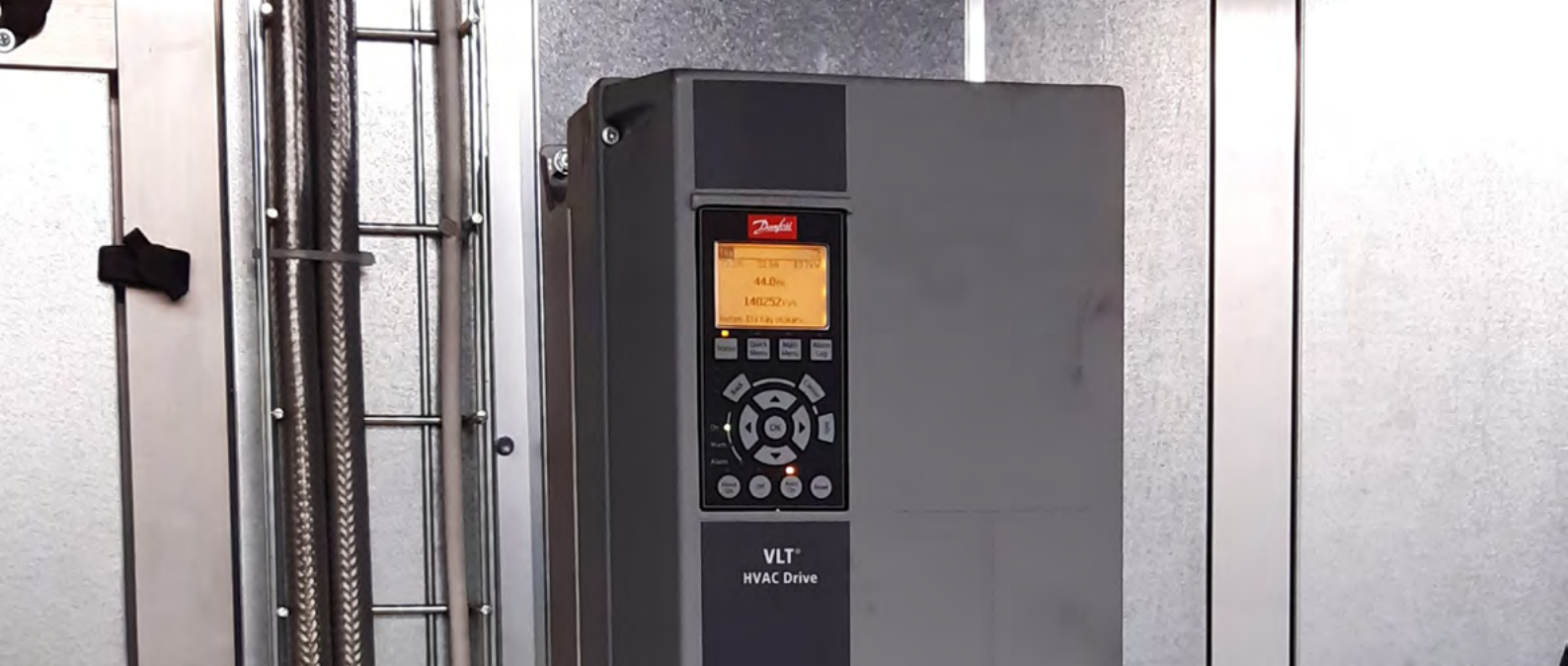
Tuloilmakoneen taajuusmuuttaja. Kuva: Teemu Heikkinen.
